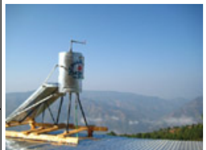
Solaranlage überm Waschhaus
